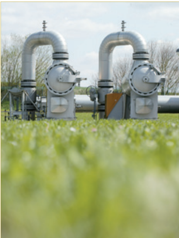
Erdgasstation: Das vorhandene Erdgasnetz dient als Verteil- und Speicherstruktur für synthetisches Methan. Zudem dürfen bis zu 5 Volumenprozent Wasserstoff direkt ins Erdgasnetz eingespeist werden. (Foto: bayerngas)
