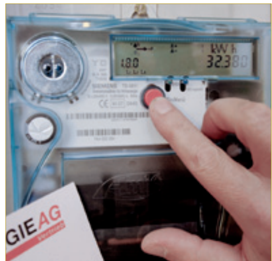
Mit intelligenten Stromzählern können Kunden ihren Stromverbrauch zeitgenau prüfen, steuern und so Kosten senken. (Foto: Siemens)
