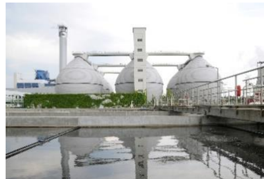
Abb. 1: Kläranlage (Symbolbild); ©BAM
