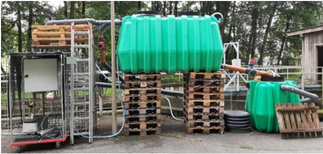
Abb. 2: Versuchsanlage zur Nachbehandlung von gereinigtem Abwasser in Kooperation mit utp Umwelttechnik GmbH
